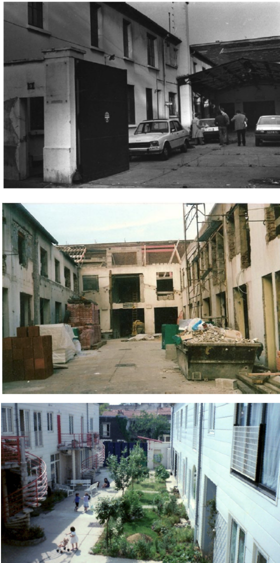
Figure 4-7 : Les transformations de l'usine en vue de l'habitat groupé autogéré : seuls les murs sont conservés, puis couverts d'un bardage
